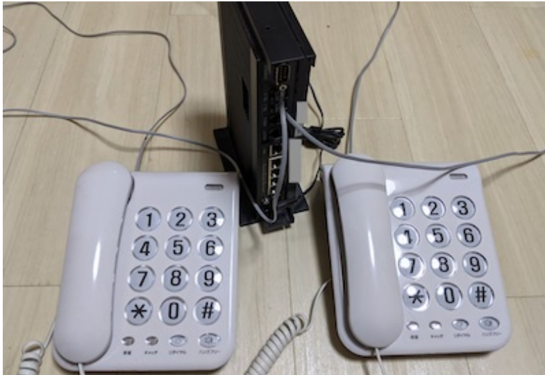
▲図 6.3 VoIP ルータを用いた内線電話
